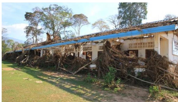
図 21:被災した小学校。日本の援助で建設されていた(2018 年 12 月撮影)
